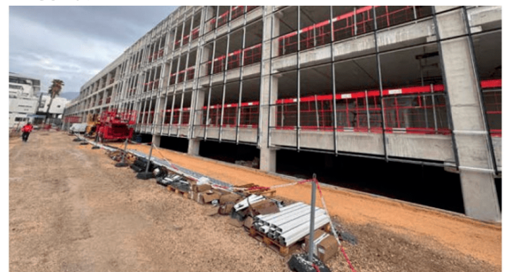
© Groupe Lorillard - ici le bâtiment P16, composé de modules préfabriqués assemblés en gros oeuvre.
